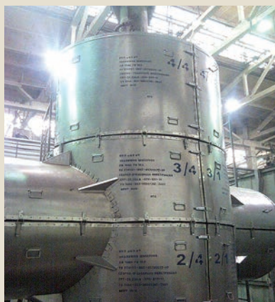
Рис. 7 Задвижка в теплоизоляции
